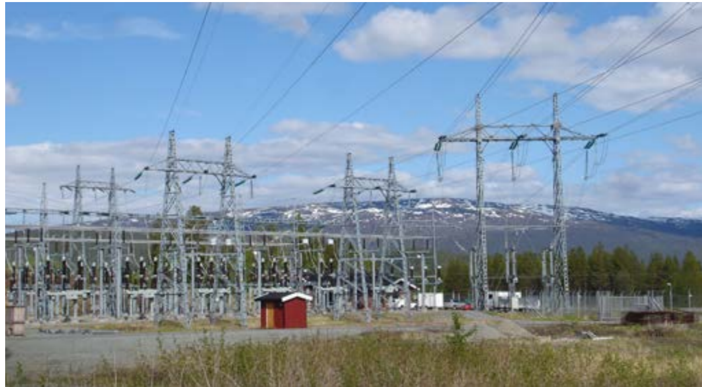
Foto: Statnett SF
