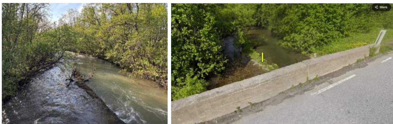
Figur 3 Vegetert "øy" nedstrøms eksisterende bru. Bildet til venstre fra befaring 16.06.2025, bilde til høyre juli 2025 fra Google Maps
